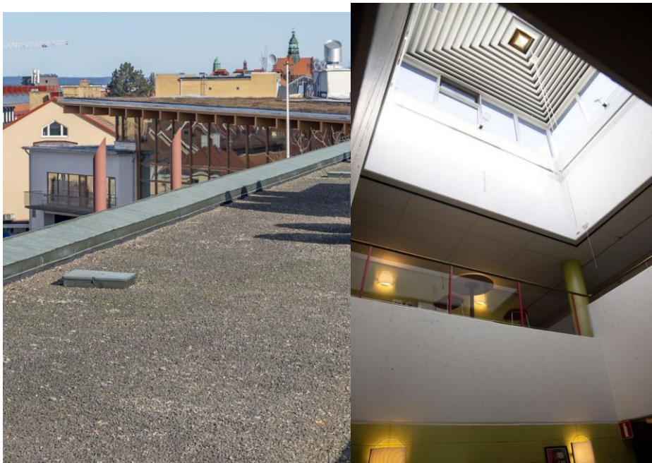
Bild. Till vänster. Landsstatshusets platta tak med kopparsarg. Till höger. Ett av ljusschakten med taklanternin. I bilden syns även den konstnärligt uppförda ljudabsorbenten samt de ursprungliga räcken som finns i ljusschakten.
