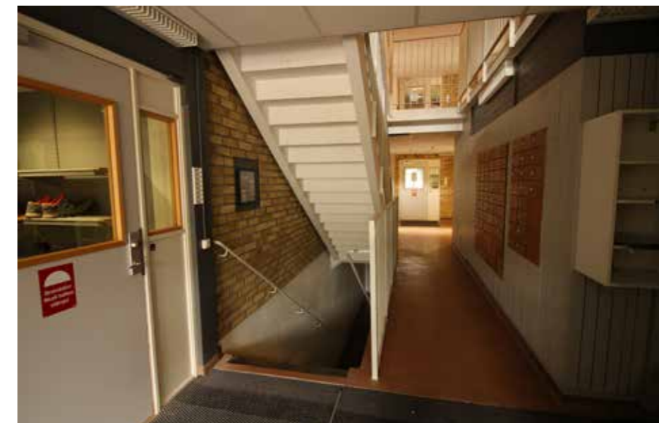
Entré och trapphus i bottenvåning. Det gula teglet pryder även väggarna på insidan. Till höger syns postrummet som har väggar av ljusgrå träpanel. Postboxarna är ursprungliga från 1960-talet. Dörren till vänster och rakt fram genom trapphuskorridoren leder till studentkorridorerna. Dörrarna är troligtvis utbytta vid 1980-talets ombyggnad.
