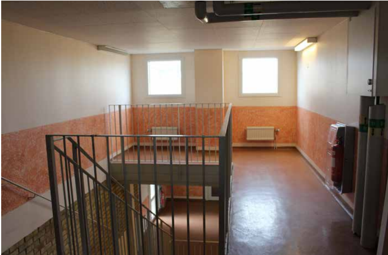
Det påbyggda våningsplanet har liksom passagerna vitmålade gipsväggar och svampmålade bröstning. Det orange-bruna linoleumgolvet är genomgående från bottenvåning till den påbyggda våningen.
