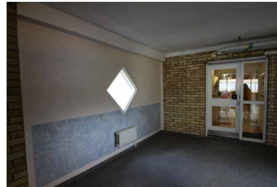
Trapphuspassagerna som sammanlänkar husvolymerna har vitmålade gipsväggar dekorerade med svampmålade bröstningar i kulörta färger vilket kontrasterar mot de ursprungliga tegelväggarna.
