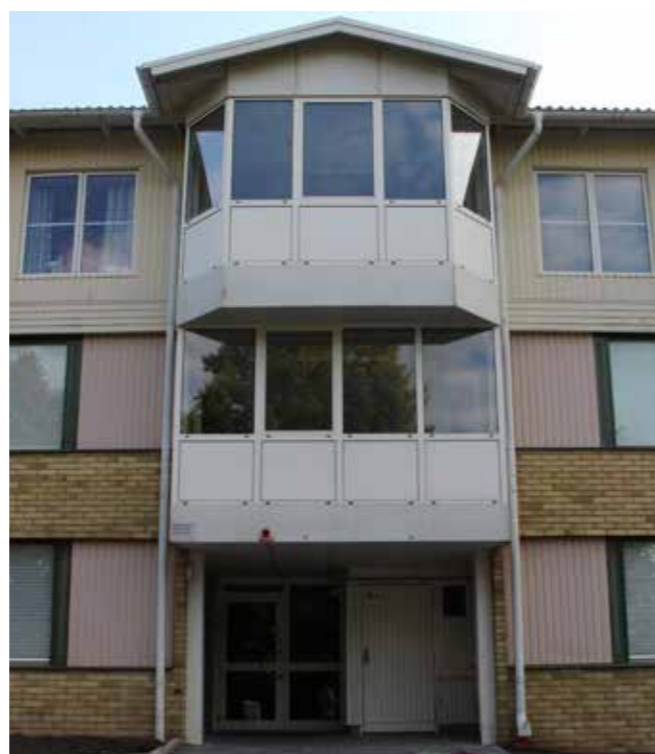
Entrépartiet med entréport utbyttes i slutet av 1980-talet i samband med påbyggnaden.
