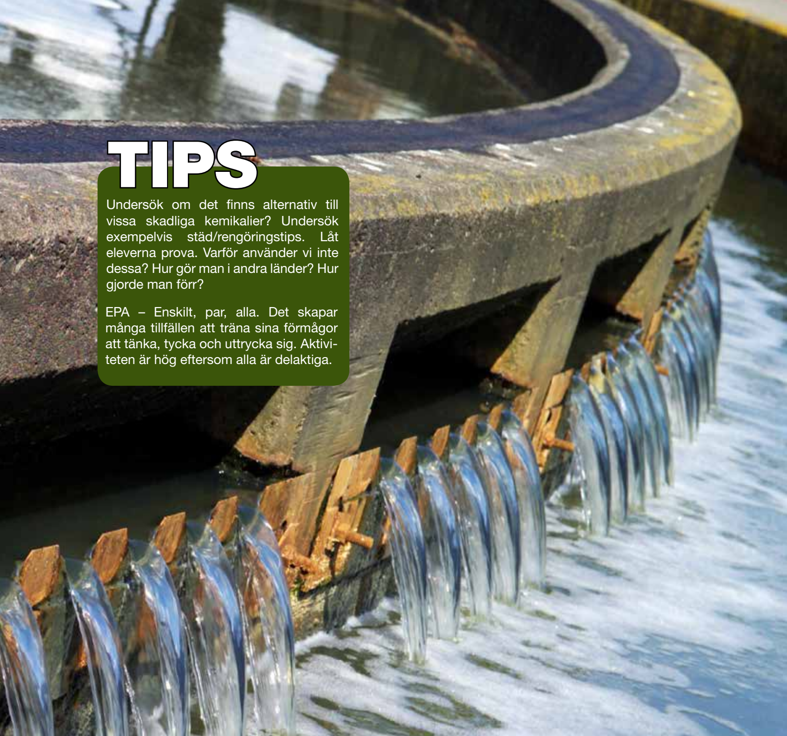
Reningsbassäng i Linköping Foto: Tekniska verken
